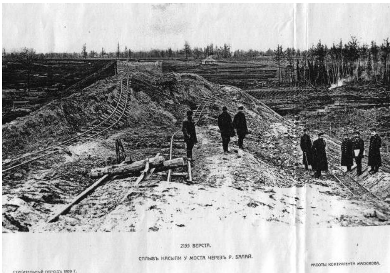
2155 верста. Сплыв насыпи ж.д. Строительный период 1909 г.
