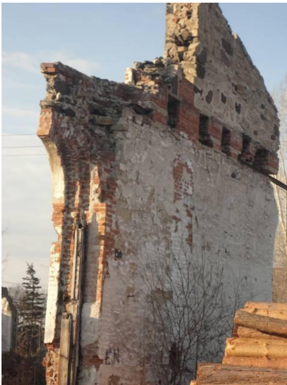
Разрушенное здание второго паровозного депо на шесть стоек, существовавшего в 1916 г. Год постройки неизвестен.
